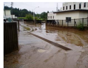
9月17日 米代川氾濫時に冠水した施設前道路の翌日の状況
